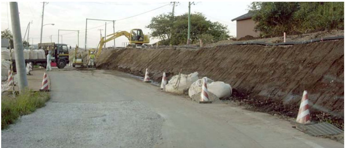
第 8 図 修復中の盛土の下部には湧水で湿った状態が見られ、地震時には盛土が液状化もしくは液性限界を超えて崩壊したと考えられる。隣接する道路自体にはうねりなどの変状は見られない。
