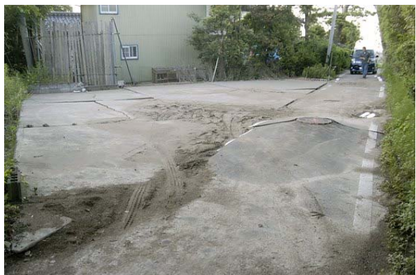
第 4 図 池に隣接する道路の液状化被害 道路に隣接する、コンクリートとの境目は開いて噴砂があり、マンホールが抜け上がっている。
