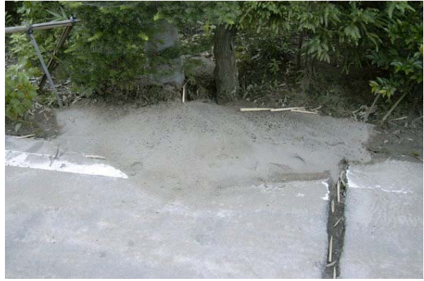
第 6 図 道路の池側の縁の噴砂. 吹き上げた砂の中には貝殻の小片が含まれていた。
