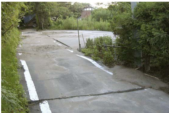
第 3 図 池に隣接する道路の液状化被害 路面は上下にうねって、池側にずれている。道路の縁からは噴砂がある。築年代の古い家屋が倒れこんでいる。
