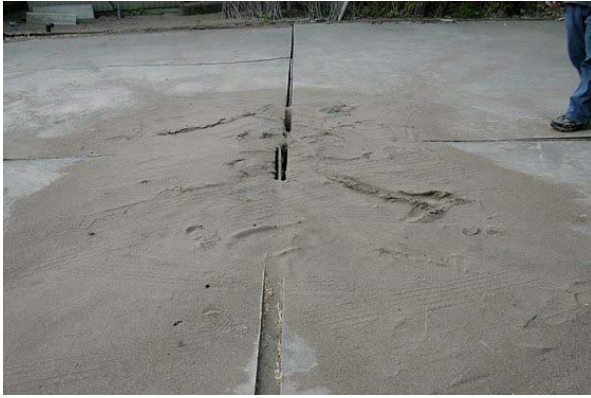
第 5 図 道路に隣接する駐車場のコンクリートのうちつなぎの部分は開いて噴砂がみられる。
