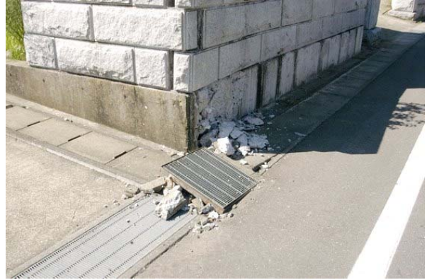
第 4 図 墓地の北東側の道路は、県道の交差部では圧縮変形していないが、ここより北西で変形している。北東側の住宅の塀は道路側に移動して側溝の圧縮変形をもたらしている。
