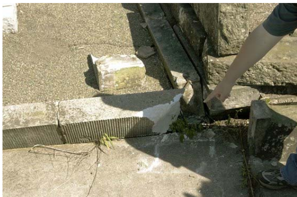
第7図 南西側から押されて破断して転倒して路面と衝突した後南東に飛行して着地した腰石の破片。
